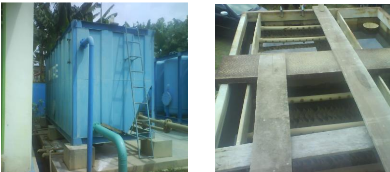
Gambar 20. Instalasi Pengelohan Air Bulotadaa
