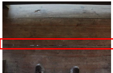
Gambar 9. Celah pada lantai Bantayo Pobo'ide. .(16 April 2015)
