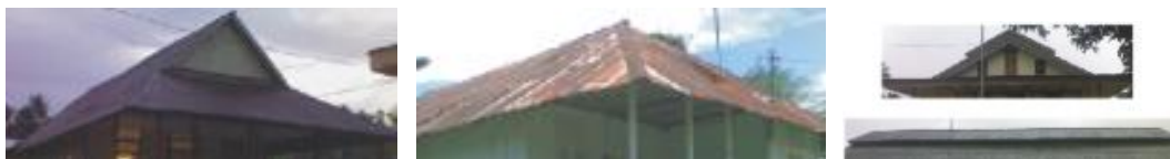
Gambar 6. Bentuk/model atap perisai (kiri), gabungan pelana dan perisai tidak bersusun (tengah), gabungan pelana dan perisai bersusun (kanan)
