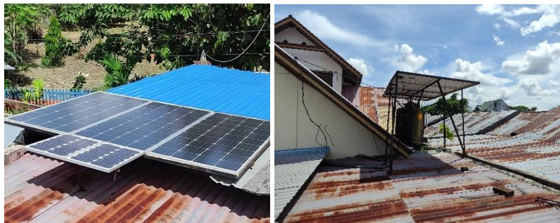
Gambar 5.5 Panel surya yang dipasang di atas garasi, dan di atas rak pada atap.
