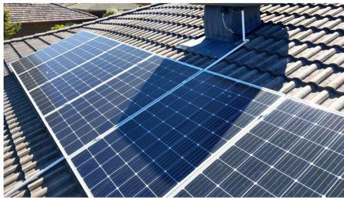
Gambar 2.2 Panel surya terbayangi oleh bagian bangunan
