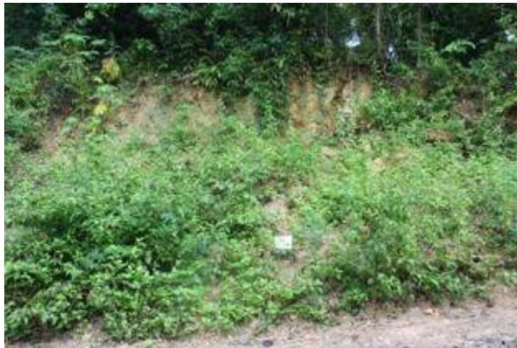
Gambar 5.23 Kondisi Longsor pada Desa Isimu Utara Kecamatan Tibawa Kabupaten Gorontalo (Sampel 7)
