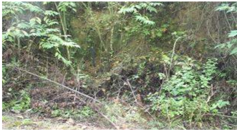
Gambar 5.30 Kondisi Longsoran di Desa Molamahu Kecamatan Pulubala Kabupate Gorontalo
