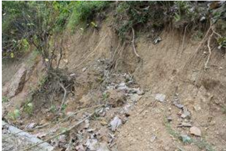
Gambar 5.28 Kondisi Longsor di Desa Iloponu Kecamatan Tibawa Kabupaten Gorontalo
