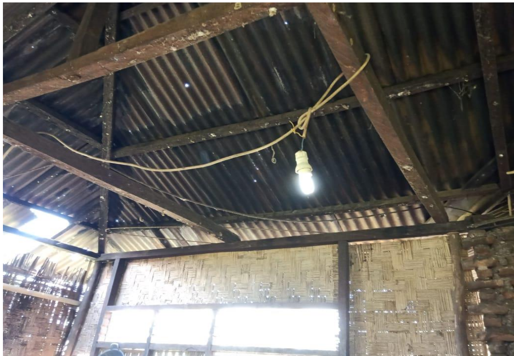
Gambar.3 Sambungan Kabel yang tidak sesuai Standar SNI
