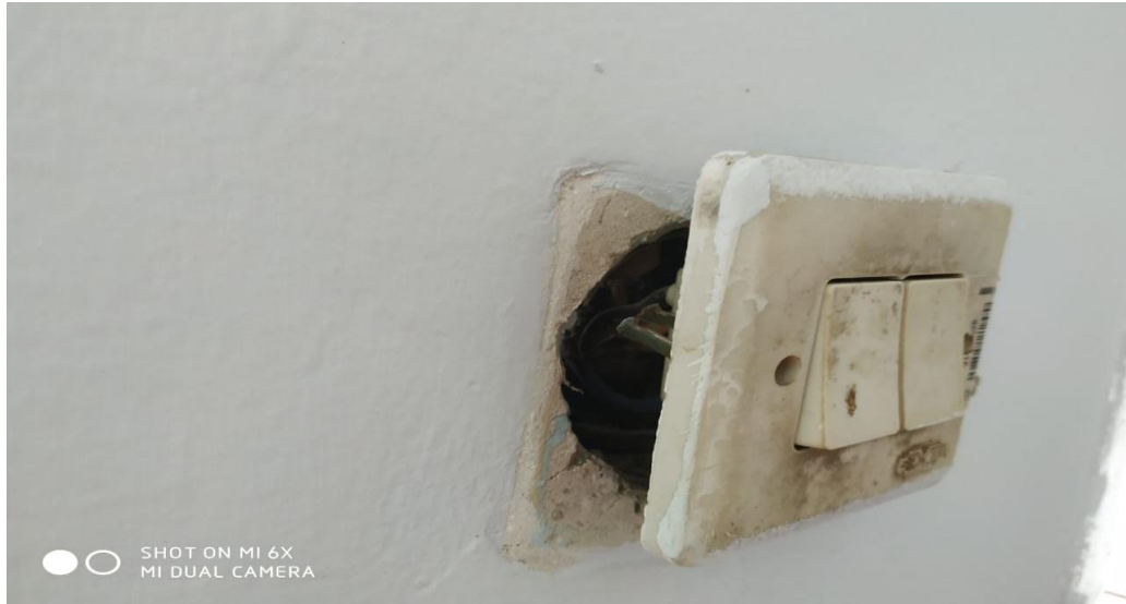
Gambar. 2 Saklar Lampu Yang Terbuka
