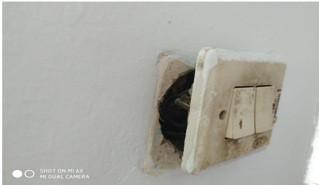
Gambar. 2 Saklar Lampu Yang Terbuka
