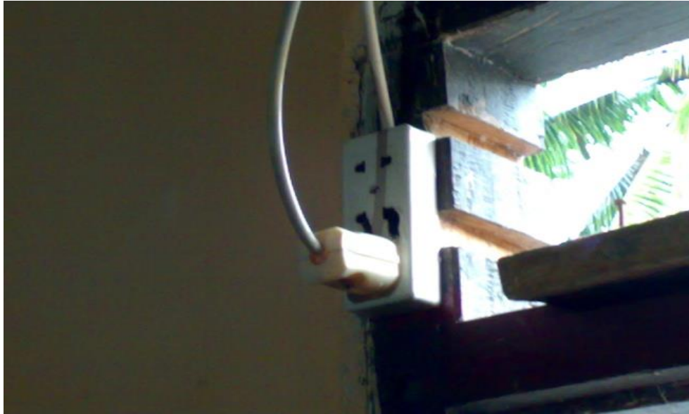
Gambar 1. Kotak Kontak yang tidak sesuai Standar SNI
