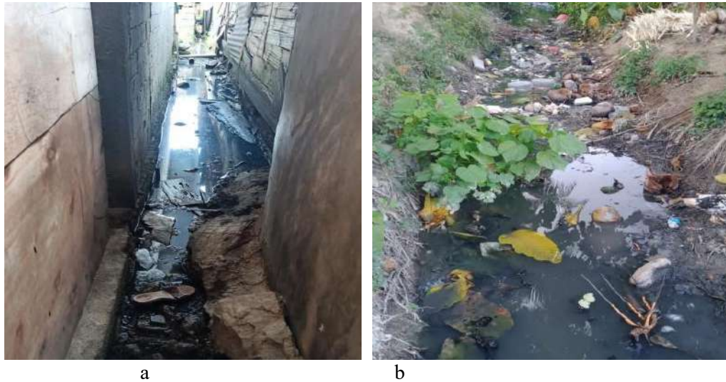
Gambar 5. Sistem drainase pembuangan air limbah di Desa Rumbia (a) saluran tersumbat dan tidak mengalir; (b) sampah pada saluran air
