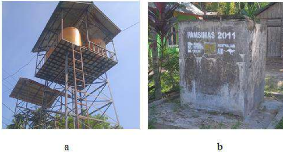
Gambar 3. Kondisi Bangunan fisik PAMSIMAS di Dusun II
