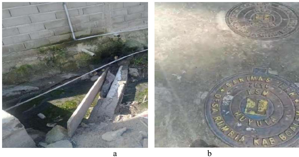
Gambar 6. Pipa pembuangan yang terputus dari IPAL KOMUNAL di Dusun 3
