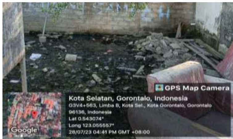
Gambar 4.3. Saluran Air yang Belum Terlayani Saluran Pembuangan Air Limbah
