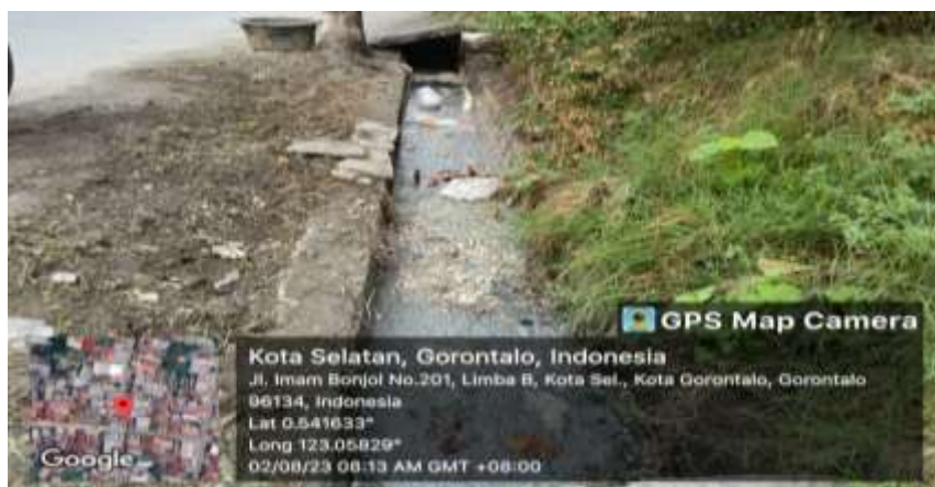
Gambar 4.7. Saluran Drainase yang Terjadi Penumpukan Sampah
