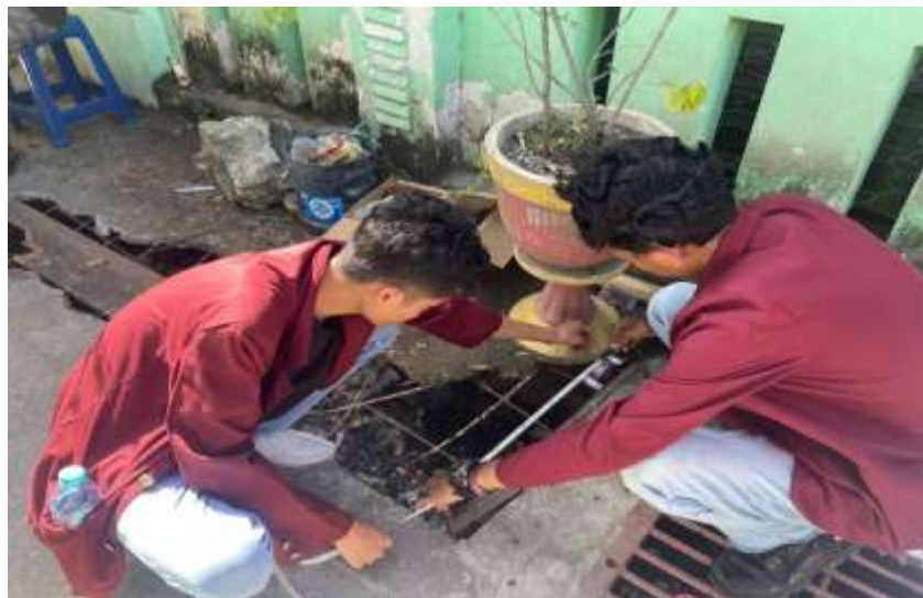
Gambar 4.6. Saluran Drainase yang Konstruksinya Tidak Terpelihara
