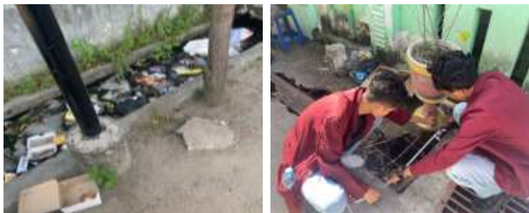
Gambar 1. a) Drainase Yang Terganggu Dengan Sampah, b) Drainase Yang Rusak Konstruksinya
