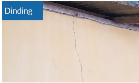
Gambar 4. 60 Kondisi Dinding Rumah Hasil Survey
