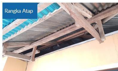
Gambar 4. 64 Kondisi Rangka Atap Pada Rumah Hasil Survey
