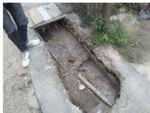
Gambar 3.22 Tanah Didalam Drainase (Sumber: Penulis 2024)
