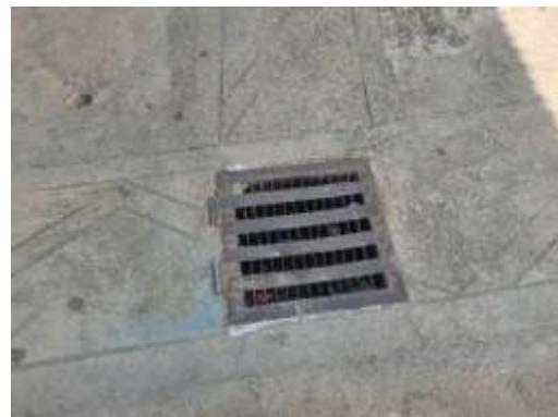
Gambar 3.26 Lubang Kontrol Drainase (Sumber: Penulis 2024)
