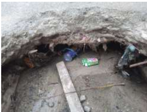
Gambar 3.27 Kerusakan Didrainase (Sumber: Penulis 2024)
